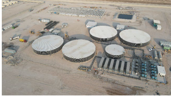
海水淡水化装置
