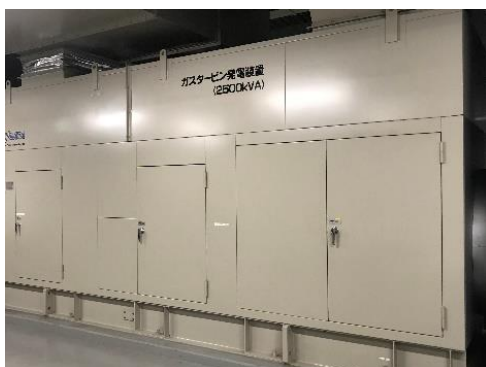
非常用発電施設
