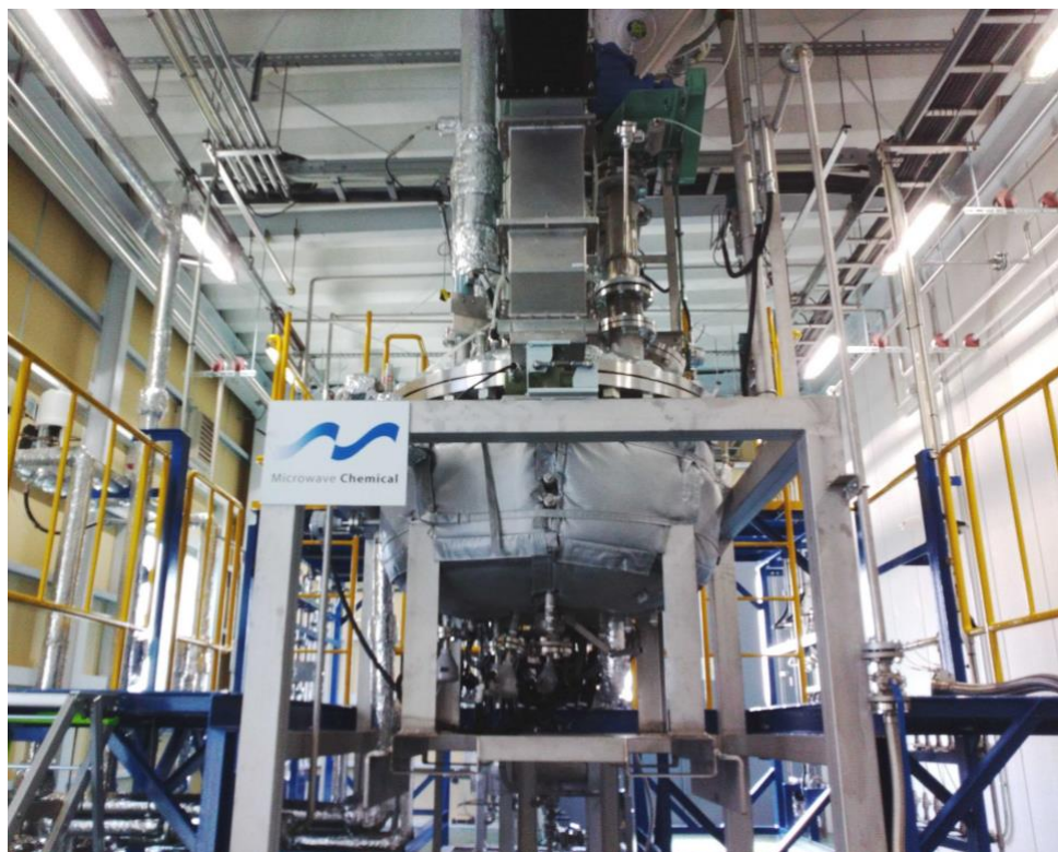
図1 今回完成した実証設備
