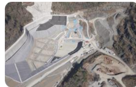
奥山の杜CC（最終処分場）
