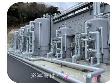
2026年4月以降 稼働予定 新規水処理施設
