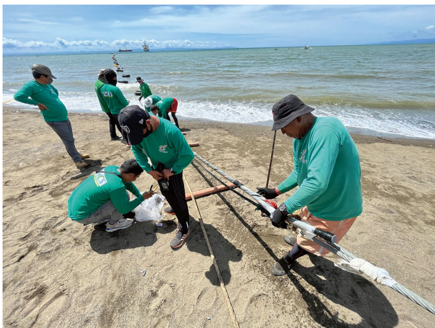
※海底ケーブルの陸揚
