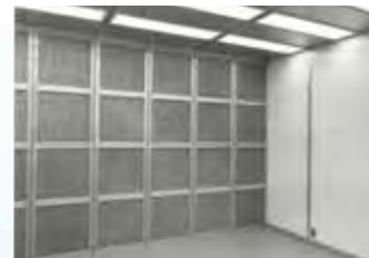
高砂層流式クリーンルーム
