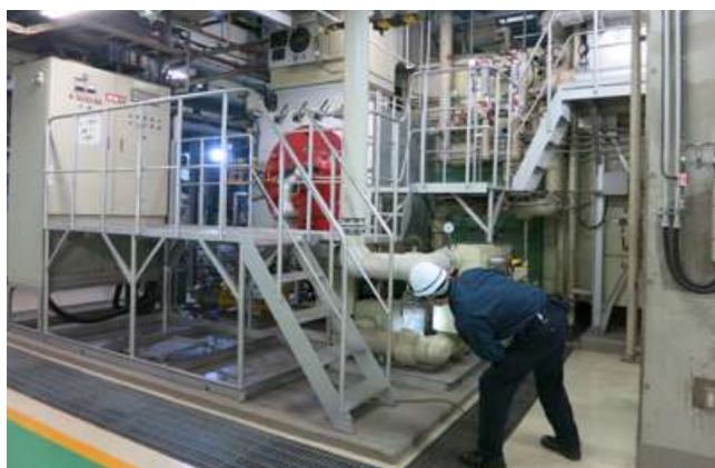
地域冷暖房設備
