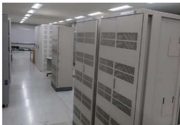
共用通信設備
