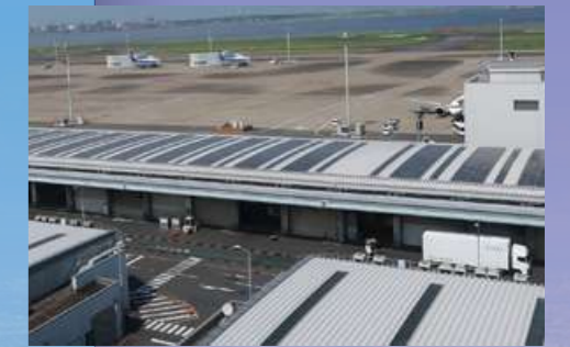
太陽光発電(羽田空港国内貨物ターミナル施設屋上)
