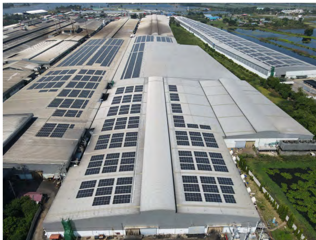
工場の屋根に設置した太陽光発電システム
