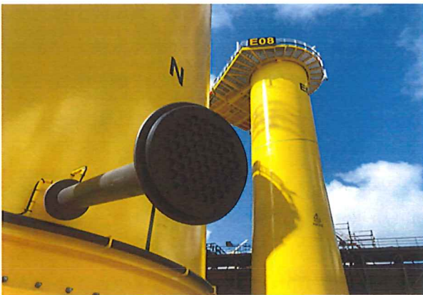
ICCP システム (External 用通電電極)
