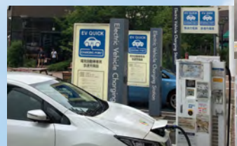
EV充電施設の設置
