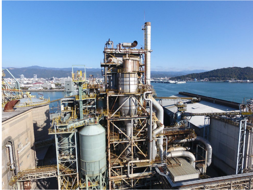
土佐発電所（高知県土佐市）
