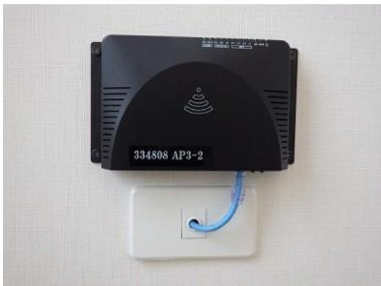
※左) 廊下設置アクセスポイント
