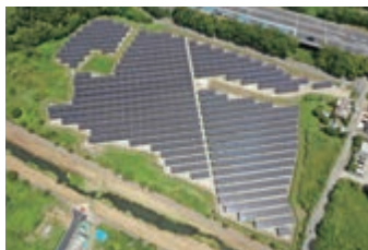
太陽光発電設備(千葉市若葉区)
