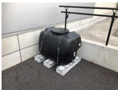
雨水貯水タンクを設置し、植栽への水や りや外構の水撒きなどへ雨水を再利用
