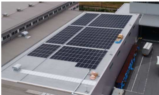
上石津工場 太陽光パネル
