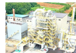
廃棄物処理設備
