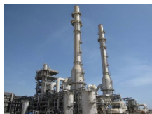
廃液燃焼システム
