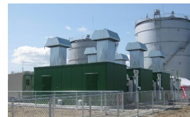
穴道湖東部発電所
