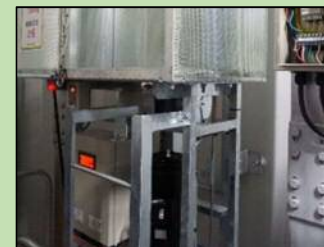
リフトの昇降装置
