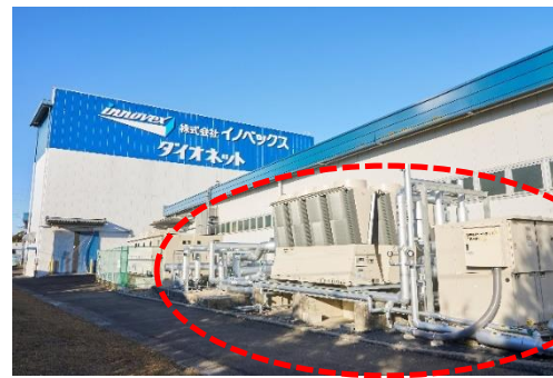
ダイオ袋井工場に導入した 地中熱源ヒートポンプ
