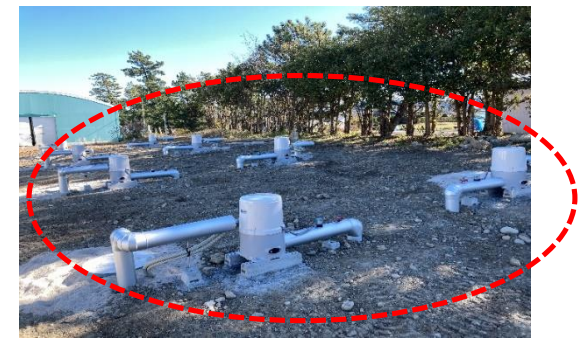
地下100~200メートルの熱を利用 地産地消の熱エネルギー
