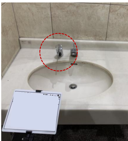
手洗い場のオートソープ設置
