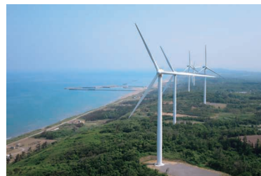
風力発電所(秋田県男鹿市)
