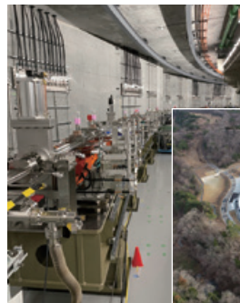
【蓄積リング用真空系機器および納入場所である次世代放射光施設】 (次世代放射光施設写真は一般財団法人 光科学イノベーションセンター 提供)
