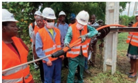
ナイジェリア国配電分野能力向上プロジェクト 作業性検証の様子
