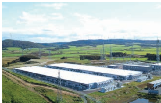
北豊富変電所蓄電池システム
