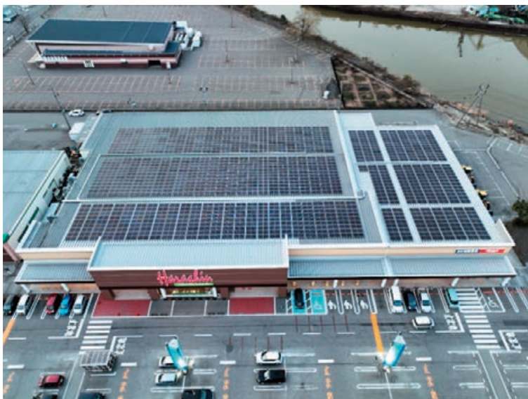
【原信河渡店の屋根に設置された太陽光パネル】
