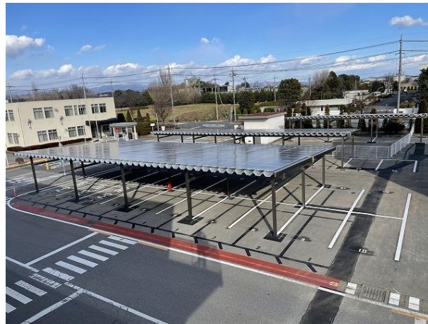
NSK 赤城工場 カーポート型太陽光発電システム
