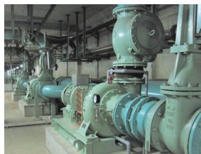
ポンププラント
