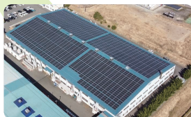
屋根に設置された太陽光発電設備
