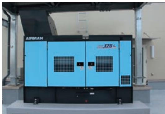
停電時バックアップ用発電機 設置現場
