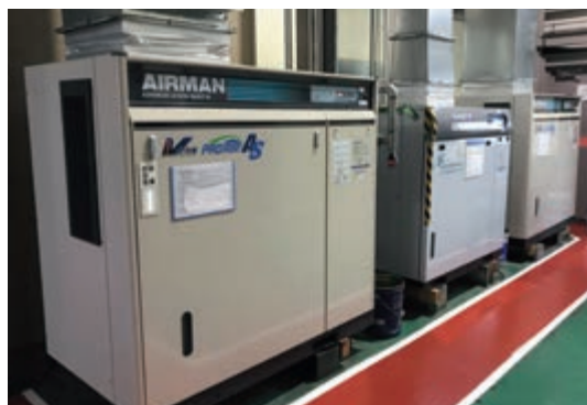
モータコンプレッサ 工場設備用設置現場
