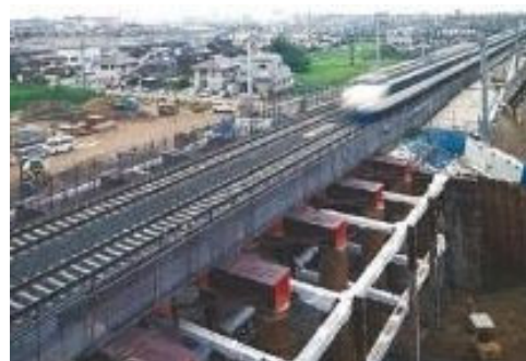
Tokaido Shinkansen Minowa Overpass
