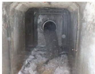
融流雪溝への送水状況
