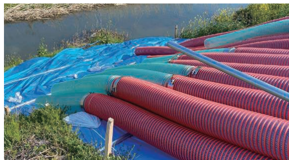
排水機場② 雨水排水先
