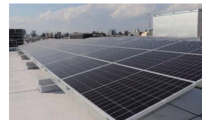
太陽光パネル
