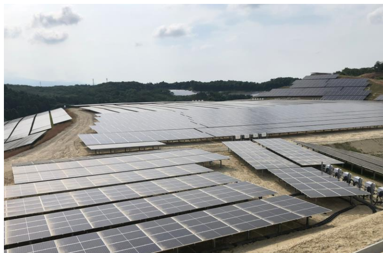
【大和町太陽光発電所】
