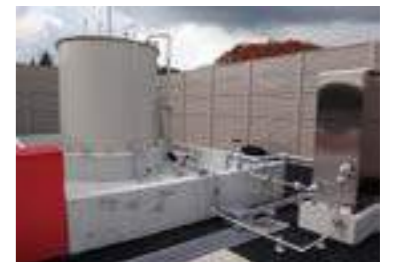
2018年9月6日の地震で北海道全域の停電が約2日続いた際、道内の生産工場と物流施設は発電設備により通常通りの稼働を行いました。
