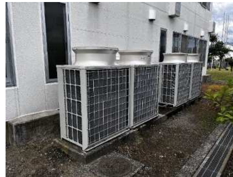
高 COP タイプの空調熱源の導入
