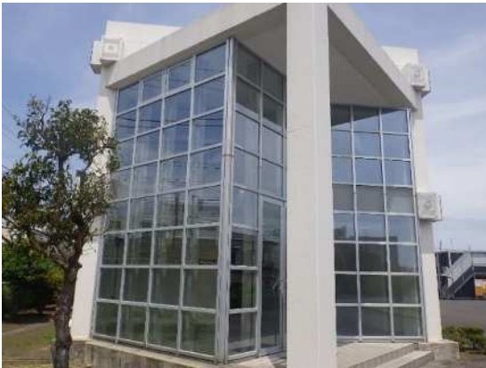
エントランスカーテンウォールのガラスを断熱遮熱性能の高い真空ガラスに更新
