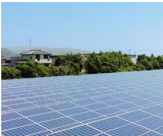
コンパクトソーラー発電所
