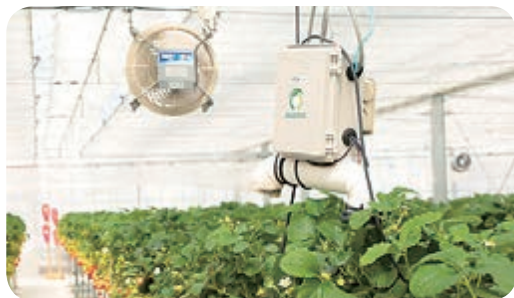
環境制御システム「アルスプラウト」
