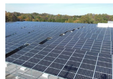
エルナー白河太陽光発電所
