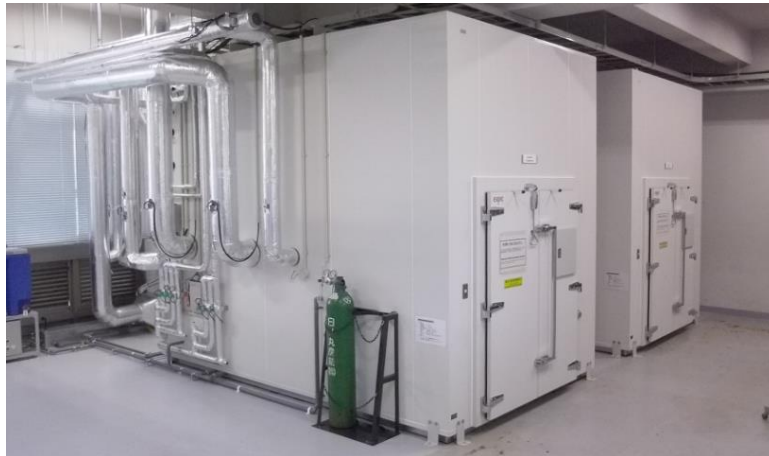
乾燥地植物気候変動応答実験設備
