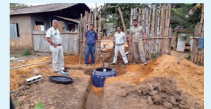
流域農家の土地へ寄贈した浄化槽
