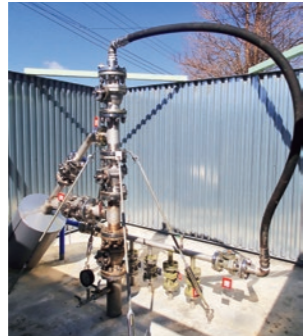
かん水・天然ガスを採取する坑井
