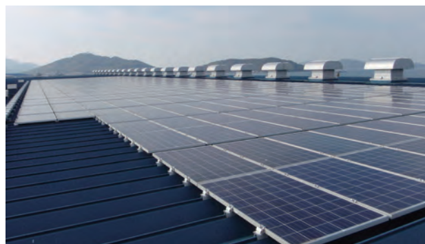
説問事業所C/Cコンポジット工場に設置しているソーラーパネル
