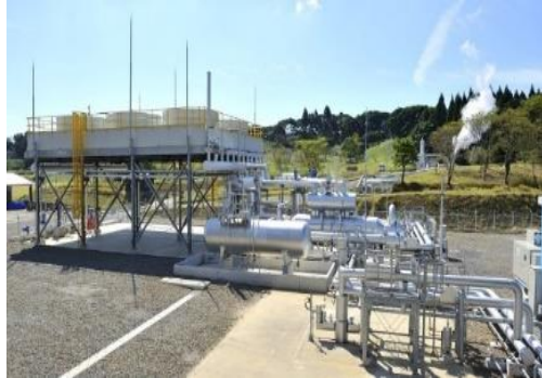
【メディポリス指宿 地熱発電所】
