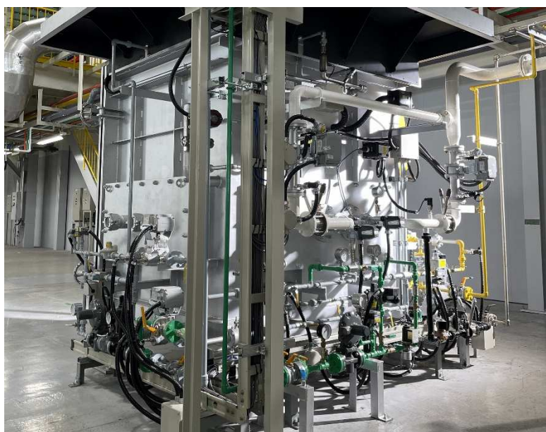
水素燃焼火炎が間近で確認できる実体加熱実演炉
