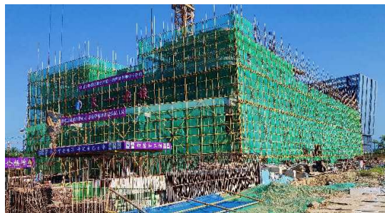
2023年11月建設中 基礎工事を終え、BNCTセンター の建屋を建設中。
