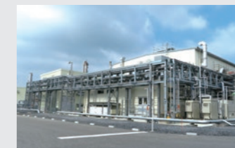
固体電解質の小型実証設備 第1プラント外観（千葉事業所内）
