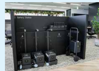
バッテリーステーション
