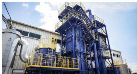
富士宮工場環境設備
