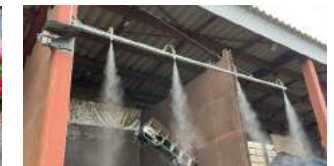
工場内の粉塵対策の実施
