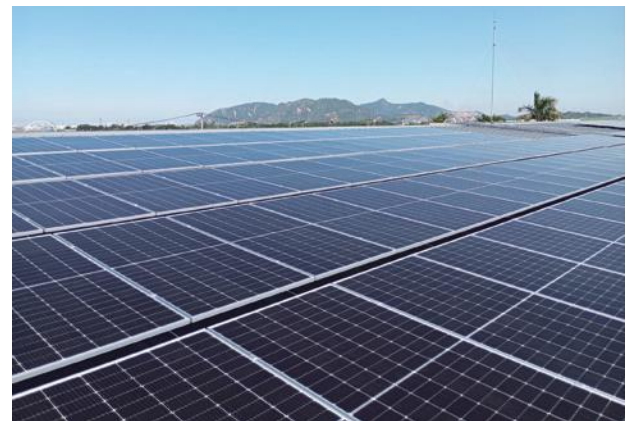
工場屋根に設置された太陽光パネル (TPT)
