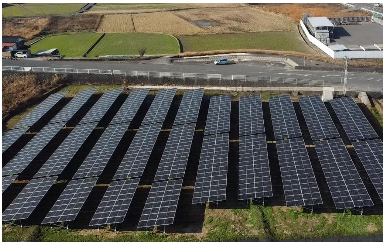
〔岩国太陽光発電所〕
