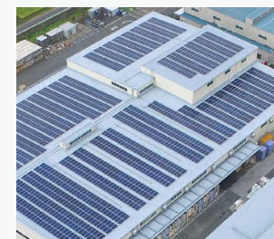
浜松事業所内に設置した太陽光パネル
